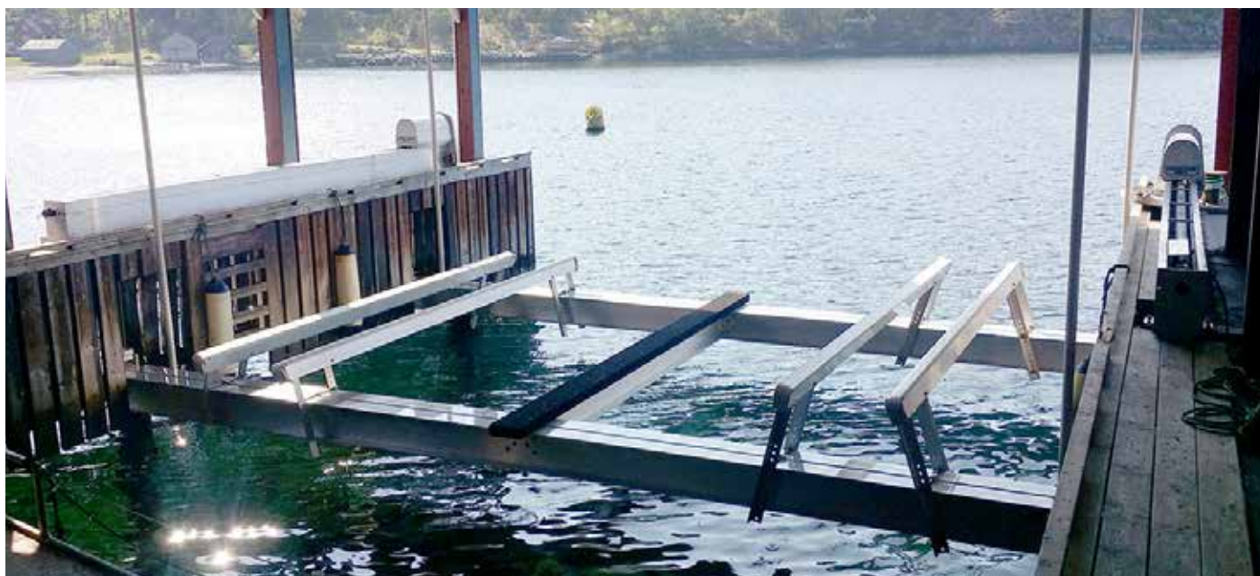
Superlift 15 tonn montert i båthus, med plass til 2 båter
